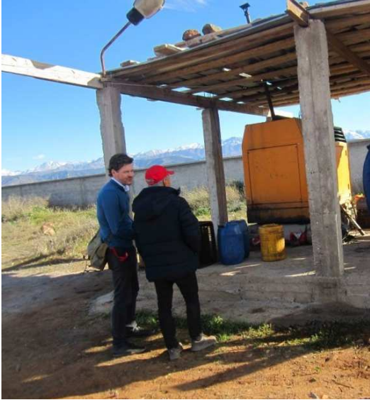
Der teure Dieselgenerator
